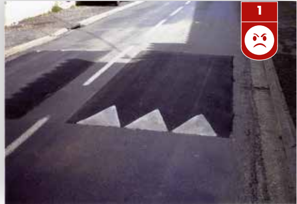
" Zone 30 " avec réducteur de vitesse mais ralentisseur posé trop près du trottoir.
